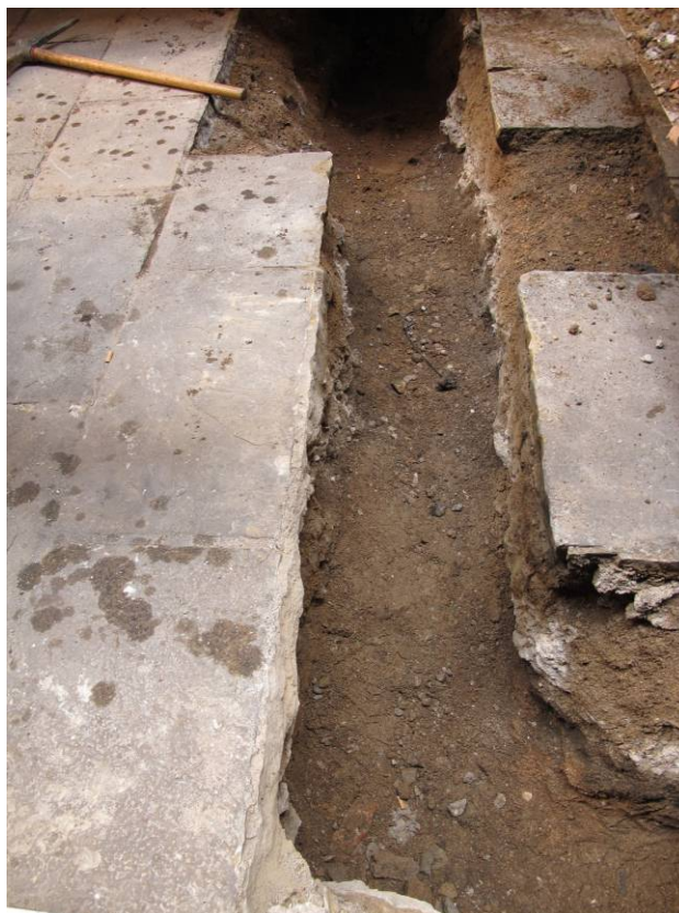
Foto 17: Creuament fins a immoble 6
